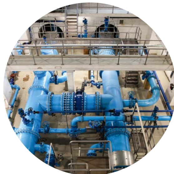
Schieberstation Hochbehälter Burzelberg
