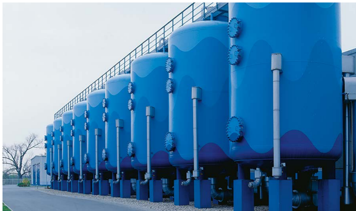
Trinkwasseraufbereitung im Wasserwerk in Halle-Beesen.
